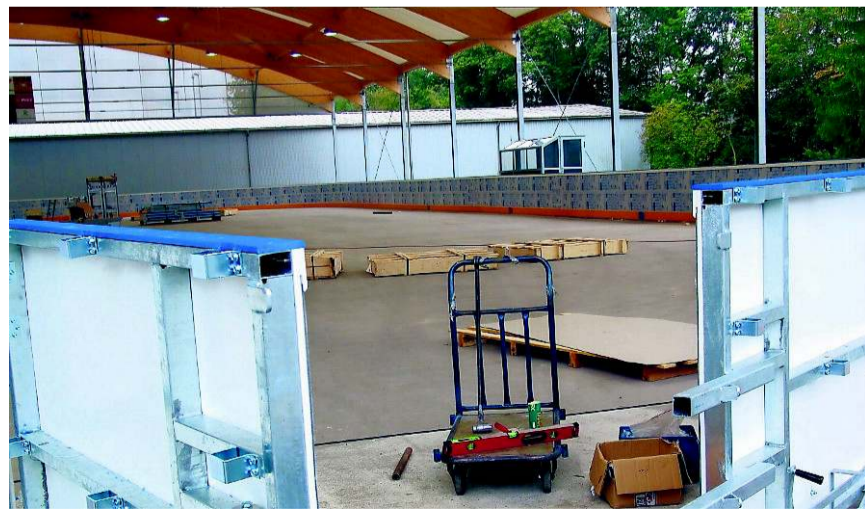
Die Sanierung der Eisbahn Weihermatt kostete mehr als erwartet. FUO
